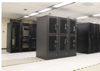
Virtualを提供しているデータセンター内部
