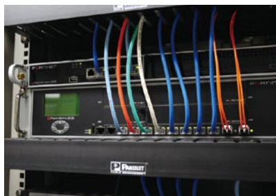
MeX VDCのシステムに組み込まれたFortiGate-3810A
